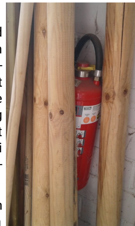
Ein verstellter Feuerlöscher verzögert die Brandbekämpfung Bildquelle: SVLFG
