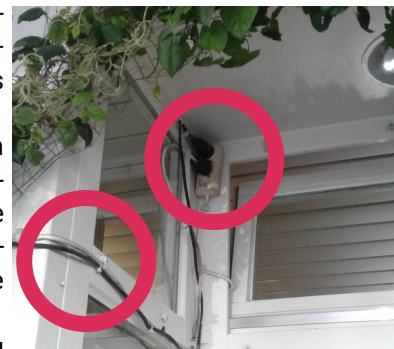
Improvisierte Außenverkabelung, Kabel durch gekipptes Fenster geführt, Steckdose nicht für Außenbereiche geeignet. Bildquelle: SVLFG
