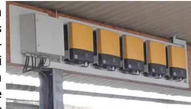
Wechselrichter einer Photovoltaik- anlage Bildquelle: SVLFG
