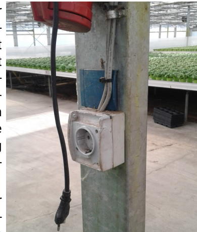
Defekte Feuchtraumsteckdose im Gewächshaus Bildquelle: SVLFG
