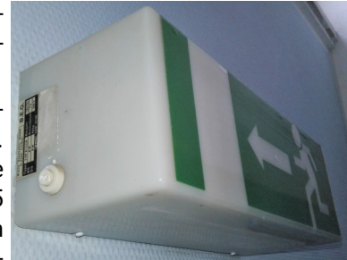
Kennzeichnung eines Notausgangs mittels Sicherheitsbeleuchtung Bildquelle: SVLFG
