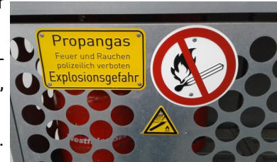
Belüftete Gaslagerbox mit eindeutiger Kennzeichnung Bildquelle: SVLFG
