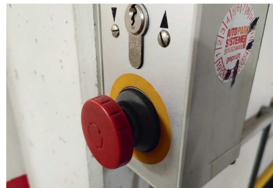
Nachgerüsteter Not-Aus an einer Maschine Bildquelle: SVLFG
